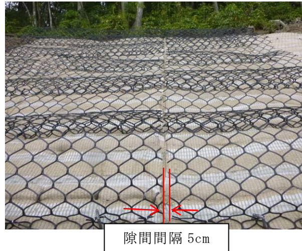
写真-18. アーチブロックの隙間間隔
